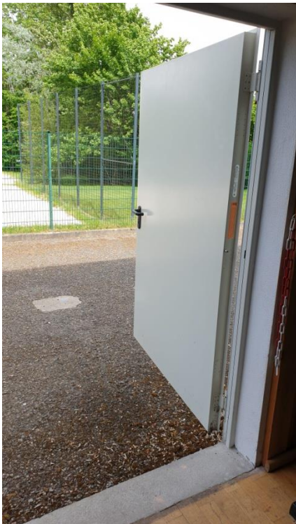
Abbildung 2: Darstellung der breiten Außentür zum Stoßlüften.
